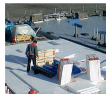
Seit August wird das rund 15 000 Quadratmeter große Flachdach des LSG-Gebäudes restauriert. (Foto:TEP)
